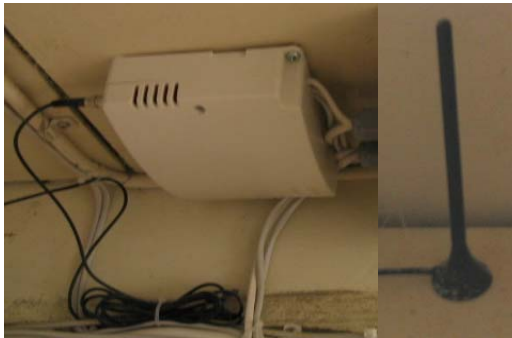
Kuva 18. Laitteiston robottipuhelimeen on kytketty vieressä näkyvä antenni parantamaan puhelinyhteyden kuuluvuutta.
