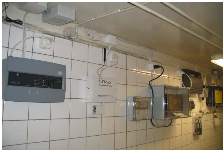
Kuva 2. Palovaroitinkeskuksia huoltotilan käytävän seinällä.
