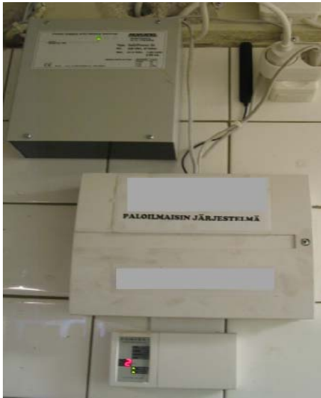
Kuva 11. Palovaroitinlaitteiston keskus, näppäimistö, antenni ja lisävirtalähde.
