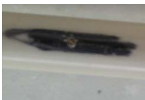
Kuva 28. Putkiston reikä on merkitty tussilla.
