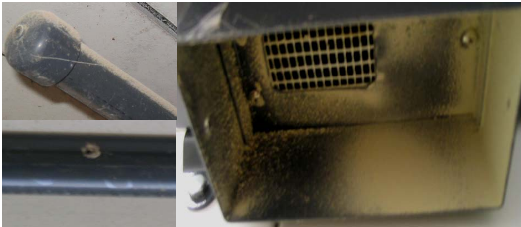
Kuva 1. Palovaroitinlaitteistojen osat altistuivat pölylle seuranta-aikana. Vasemmalla kuvia näytteenottoputkistosta, oikealla hälytyskeskuksen ilmanpoistoaukko.
