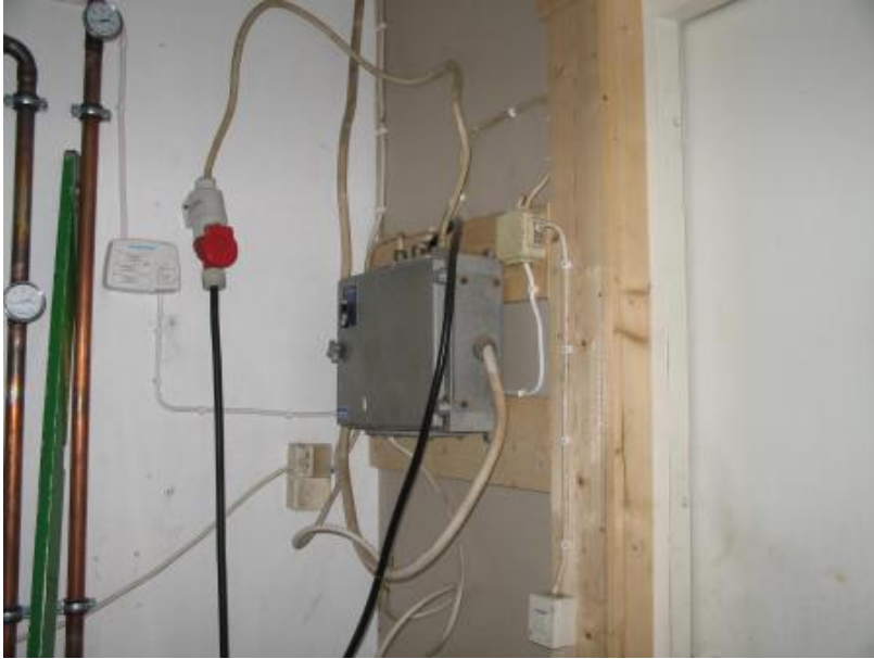
Kuva 4. Ala-arvoista asennustyötä muodollisesti pätevän ammattimiehen jäljiltä.
