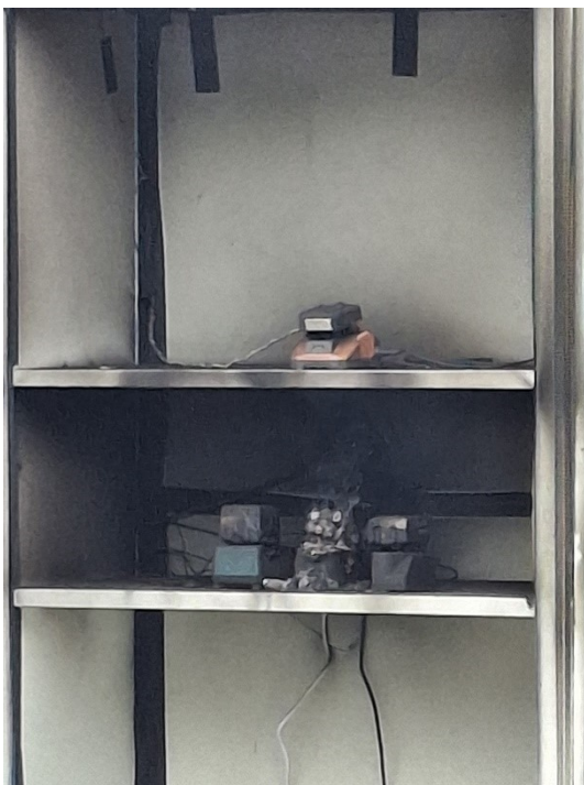
Kuva 13. Kaapin sisältä mittauksen päätyttyä
