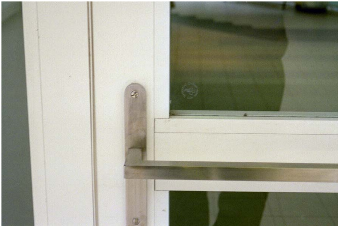
Kuva 2. Lasisen palo-oven lasi tulee olla merkattu palonkestolasi, jossa ilmoitetaan valmistaja ja palonkestoaika. Oven runko on joko terästä tai alumiinia.
